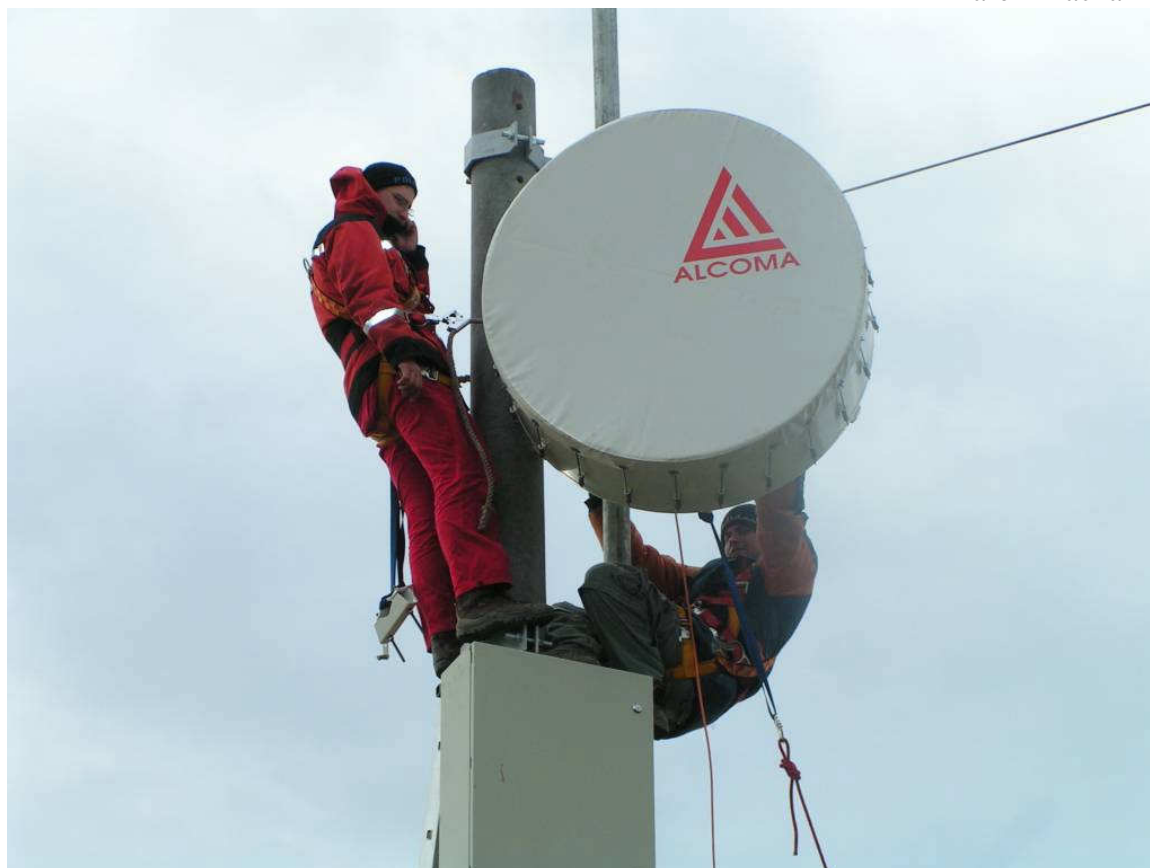
S instalací 10Ghz spoje do Zlína nám pomohl p. Macejko z UnArt Slavičín
